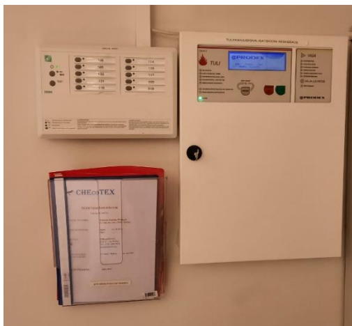
Pilt 4. Tulekahjusignalisatsiooni keskseade
